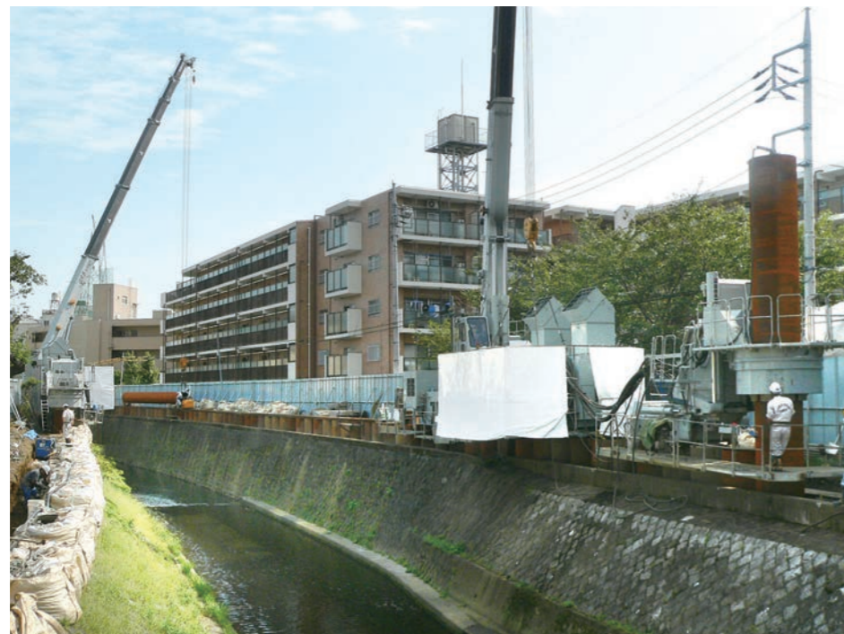
ジャイロプレス工法 ® による住宅地での河川護岸整備工事
