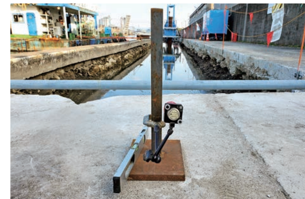
① レーザー設置
