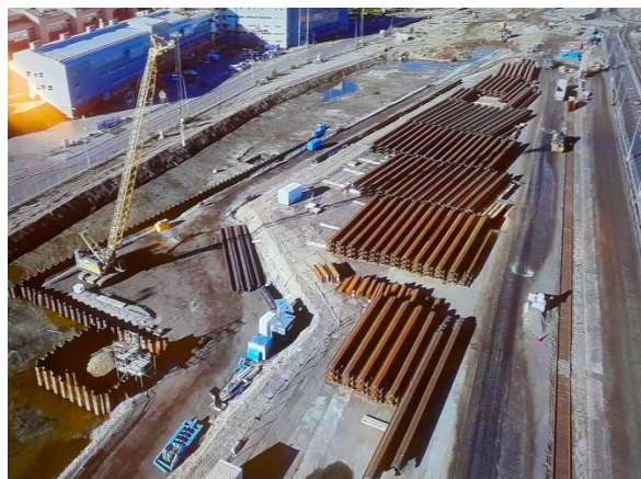
スウェーデン・イエーテボリでの地下鉄トンネルの新設に関わる工事
